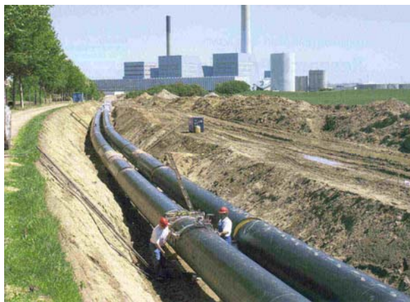
Figura 1.- Tuberías de DH [Fuente: http://www.exakm.gr/old_website_en/dh.htm ]
