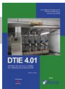
DTIE 4.01. Tuberías J.M. Pinazo
